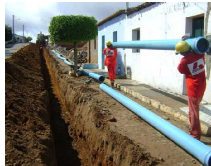
Adutora de Água Bruta – Coronel João Sá – BA Water supply network
